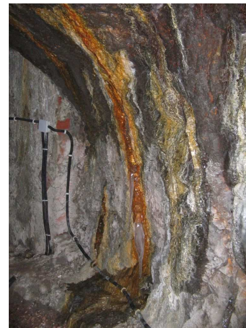
vereiste Wände von versickerndem Regenwasser durch Risse im Kirchberg
